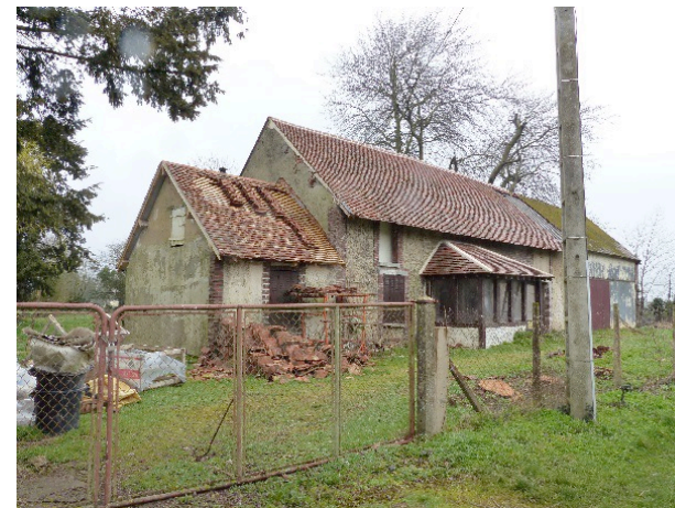
Maison ouvrière avec appentis (situé à gauche) en cours de rénovation à Les Corvées-lès-Yys (CdC Terres de Perche). (A.F Laboratoire ESO Le Mans., 2017)
