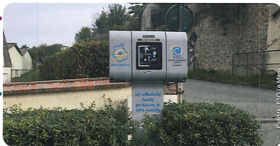
Image 29. Borne de recharge électrique, Beaumont-les-Autels
